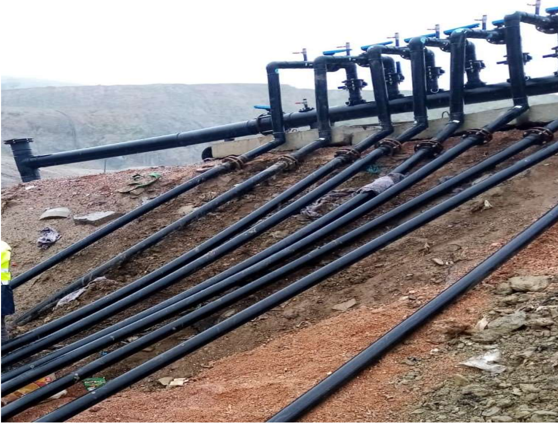
Şekil 7 Düzenli Depo Sahası Gaz Toplama İstasyonu ve Bu Yapıya Bağlı Emiş Hatları
