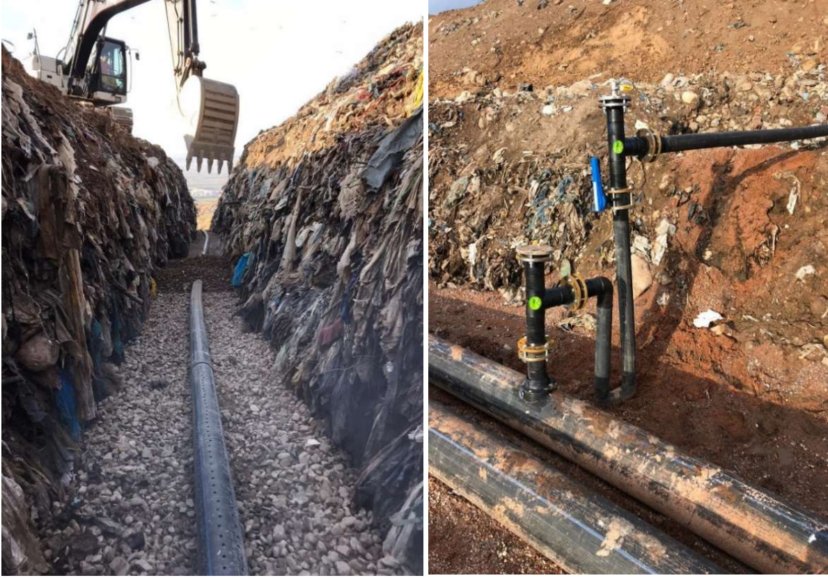
Şekil 6 Düzenli Depo Sahası Gaz Toplama Sisteminde Rigol, Sifon ve Ana Toplayıcı Drenaj Bağlantısı
